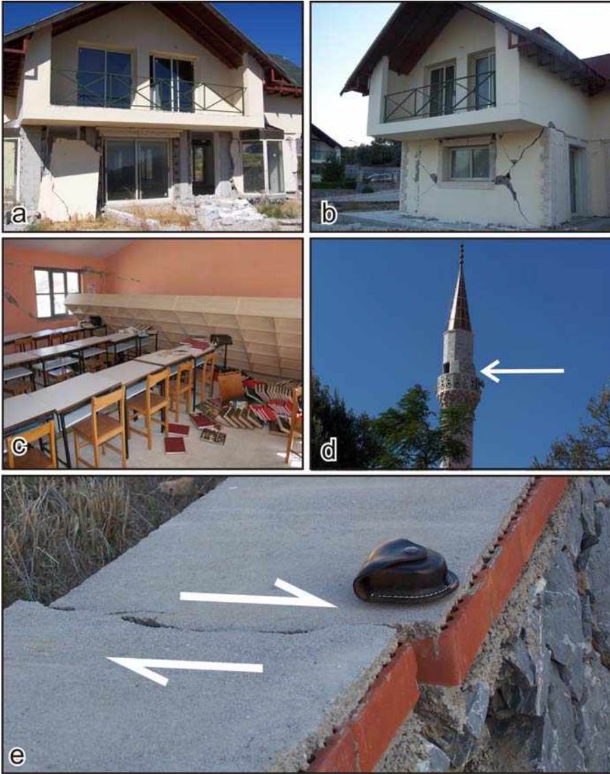
Şekil 6. Sığacık depremlerinin şiddet ölçüsünü belgeleyen hasarlar: a) ve b) villa tipi evlerde yıkılmış ve makaslanmış duvarlar, c) Sıraların üzerine devrilen Köy Kütüphanesi'nin rafları, d) Köyün minaresindeki düşey eksende kayma ve e) Bazı villaların bahçe duvarlarında gözlenen sağ yönlü ötelenmeler.
