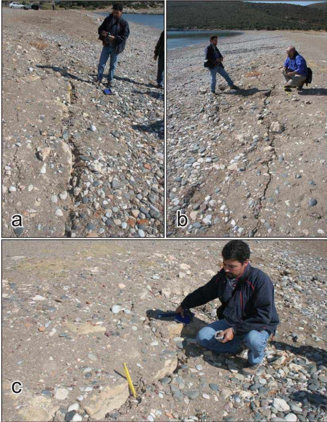
Şekil 5. Demircili Koyu'nda gözlenen yüzey deformasyonları: a) ve b) Demircili Sahili'ne koşut olarak uzanan D-B uzanlılı çatlaklar ve c) bu çatlaklar boyunca 8 cm'ye ulaşan eğim atımının görüntüsü.
